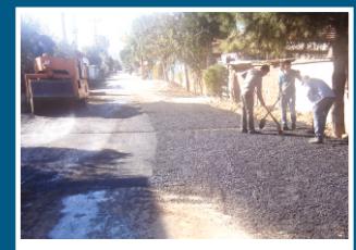
BAKLACI: İmara açılan bölgelerde kalan yolların düzenleme, çalışmaları bitirilmiş, asfaltlama çalışmaları önümüzdeki günlerde yapılacaktır.
